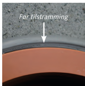
Pakningen er i riktig posisjon, men ikke komprimert
