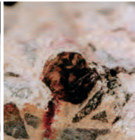
Ubeskyttet armering fra en nedsenkningstest
